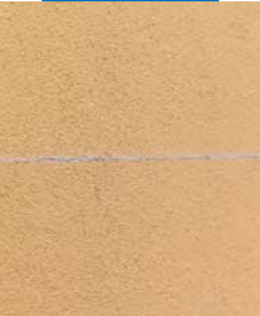
Vecchio cappotto fessurato
